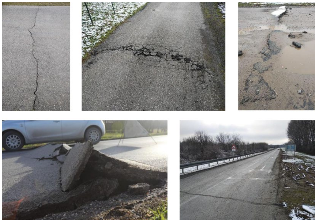
Slike 1. Prikaz oštećenja utvrđenih hitnim pregledom nakon potresa
