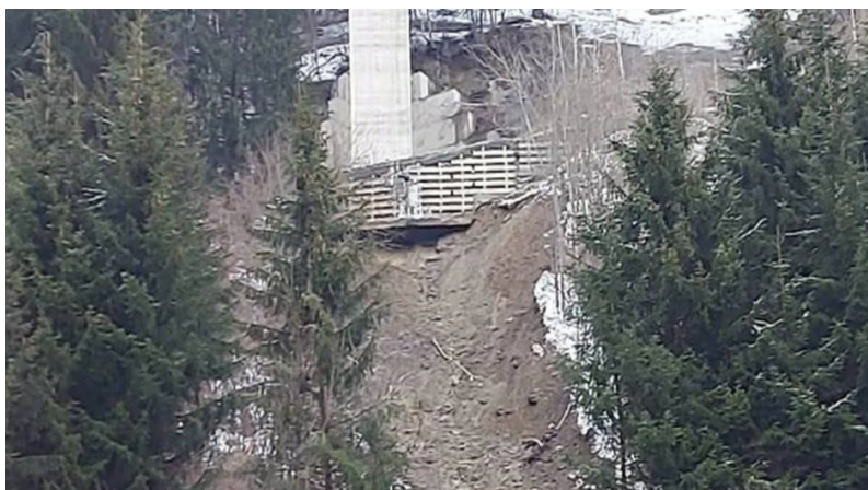
Slika 8: Dana 9. 2. 2021. nesreća na nosivu stupu vijadukta na austrijskoj autocesti A10 između Villacha i Salzburga
