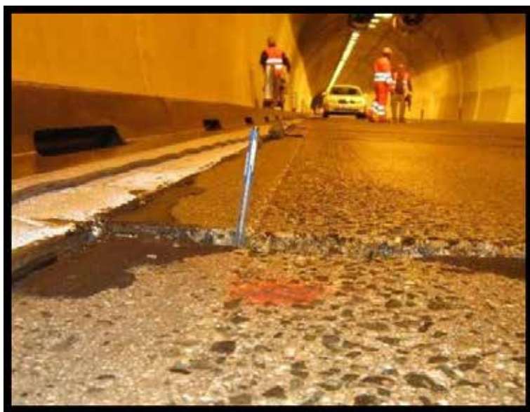
Slika 9. Vertikalni pomak između betonskih ploča
