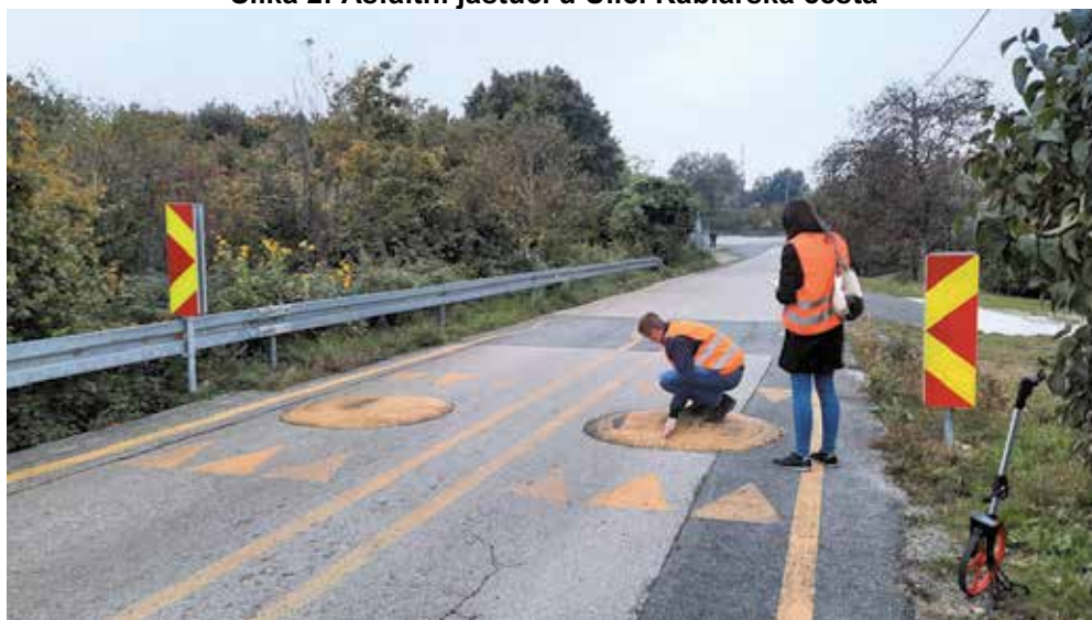
Slika 2: Asfaltni jastuci u Ulici Kablarska cesta
