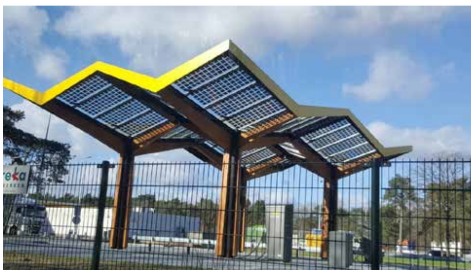
Slika 5. Odmorište Kloosters – aparati za električno napajanje i paneli za proizvodnju električne energije
