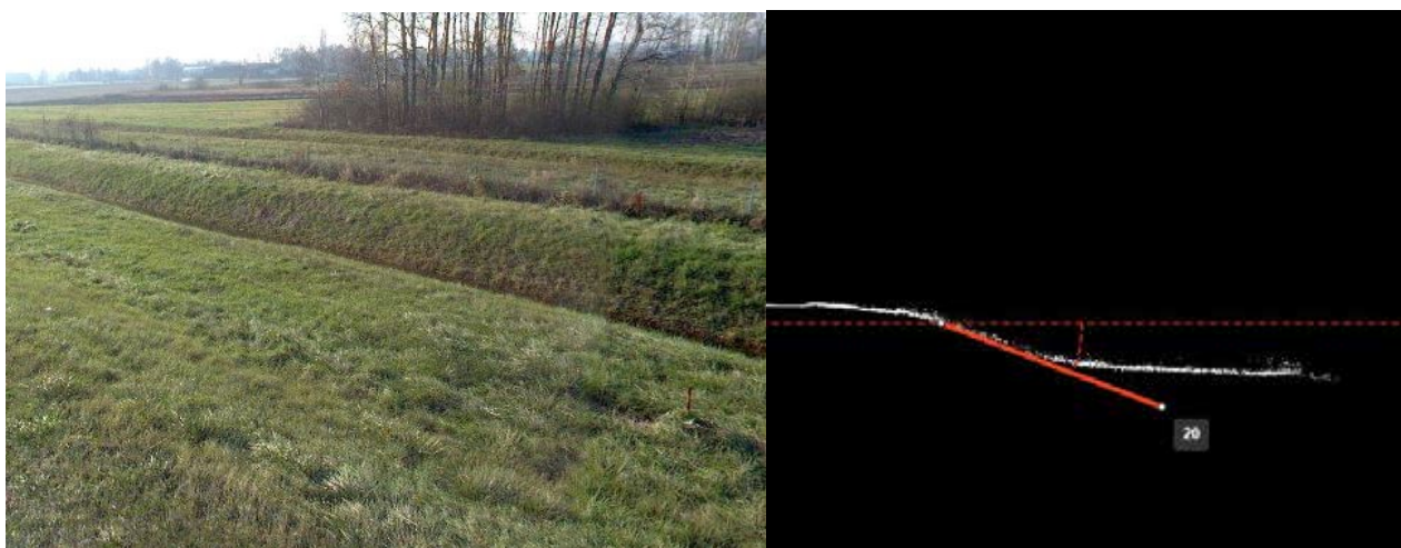
Slika 6. Nezaštićena kosina nagiba od 20°
