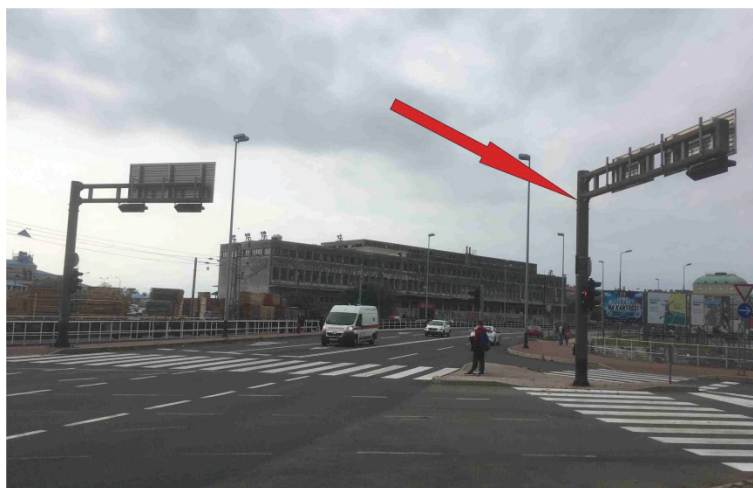
Slika 3. Nosivi stup semafora
